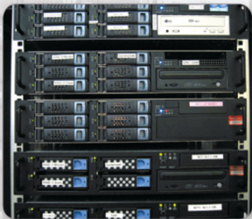
Das Storage-Array NAS01 in der Mitte des 19-Zoll-Racks stellt dem Klinik Informations System per Gigabit Ethernet alle Patientendaten durch ein Open-E NAS 2.0 online bereit.
